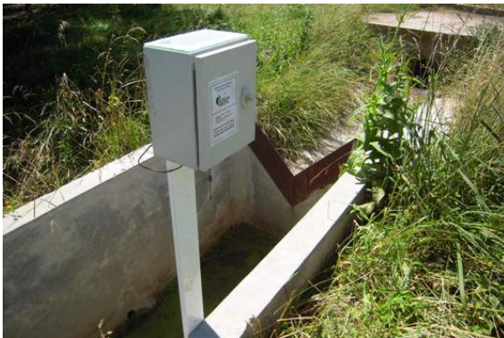
Medición de carga en vertedero triangular
