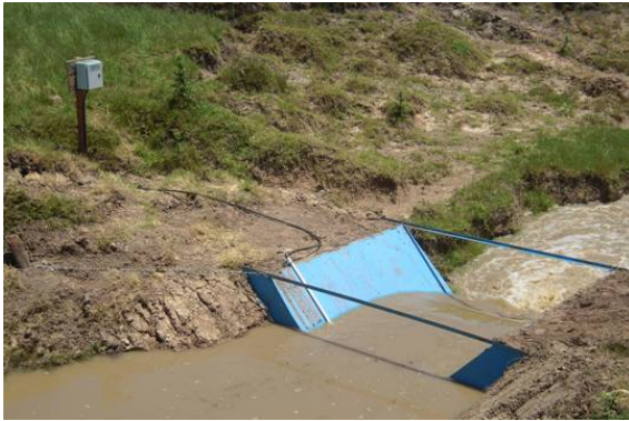
Medición de carga en aforador ACA de sección trapezoidal
