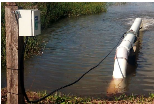
Medición de caudal mediante una placa de orificio en un tubo de descarga de una bomba.
